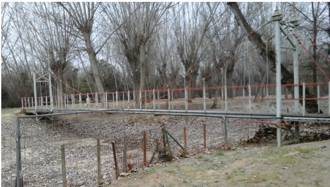
Imagen 10. Puente de cables clausurado en P.D. Puerta de Hierro
