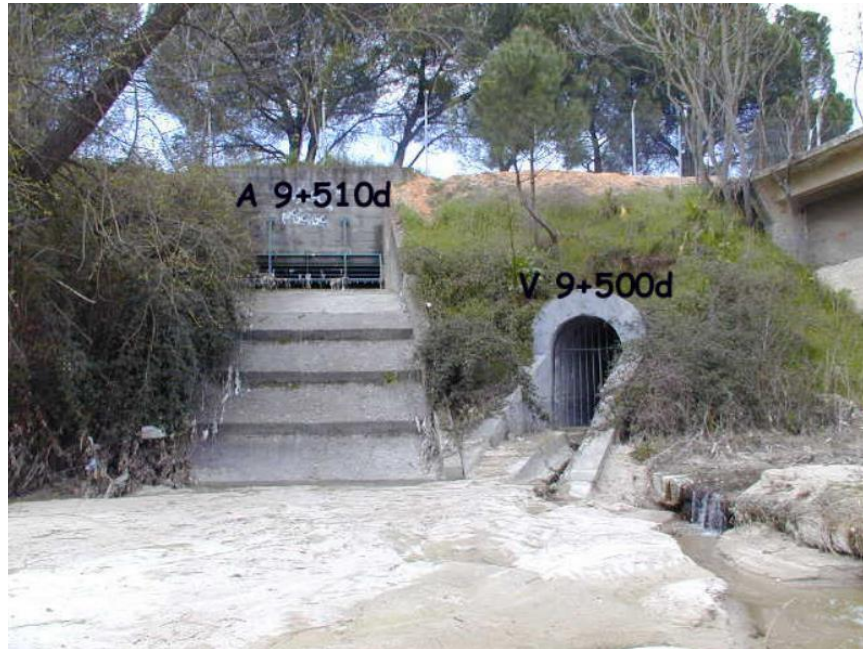
Imagen 3. Cámara (V9+500d) y colector (A9+510d) de Valdemarín (Fuente: Ayto. Madrid)
