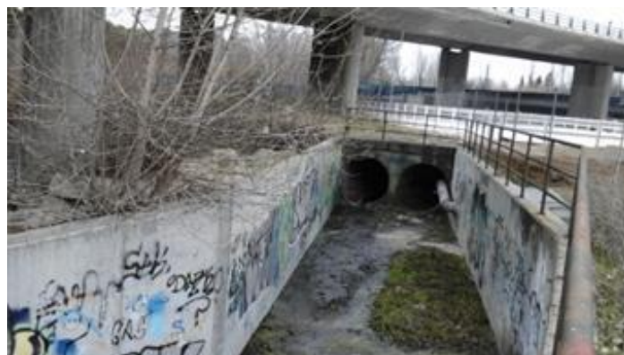
Imagen 4. Colector a la altura del paso de la M-40 sobre el río Manzanares
